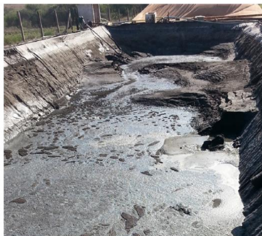
Figura 5 – Exemplo de um reator de lagoa coberta com acúmulo de material não digerido
